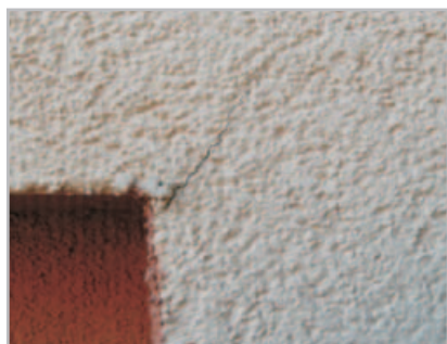
Následky nepoužití diagonální výztuže
