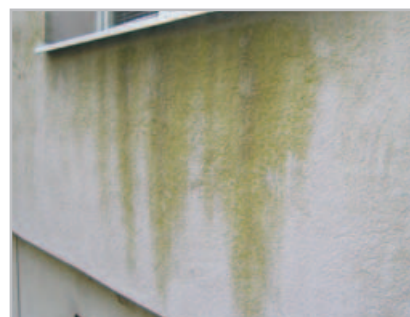
Následky špatně upevněného parapetního plechu – kondenzace vody na spodním líci parapetního plechu – stálý přísun vody pro růst řas
